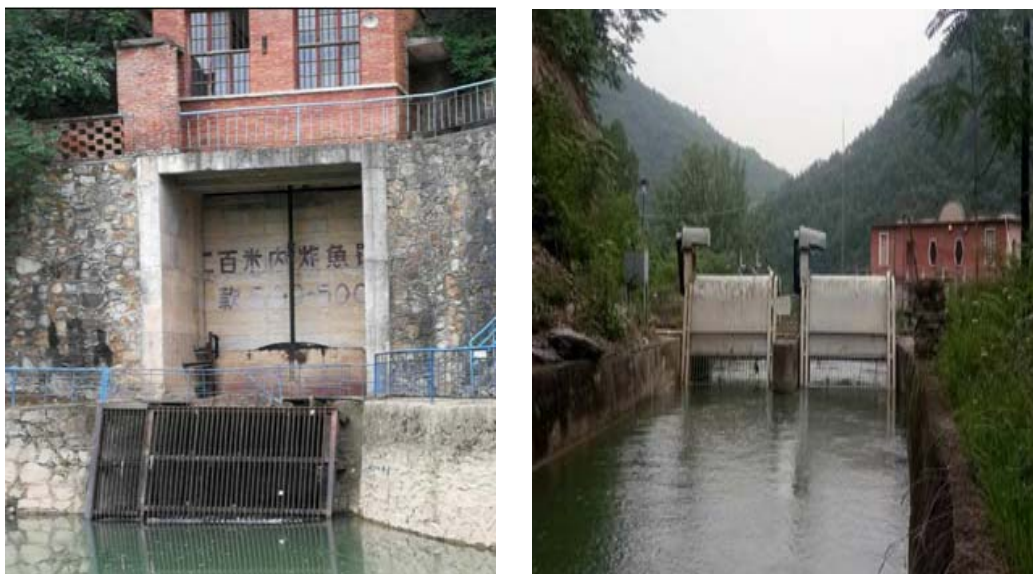
河道垃圾清理设施
